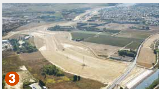
3 2007-2008 Aménagement du chenal de la Lironde de 150 à 200 m de largeur sur 4 km de longueur
